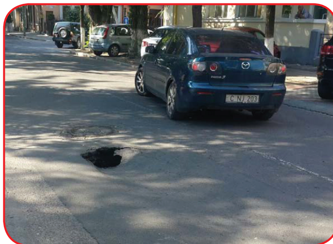
08.07.2015. Cod portocaliu de căldură (+33°C - +38°C). Deformarea drumului din cauza temperaturilor înalte.
